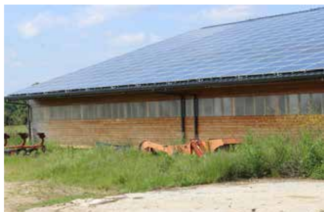
Association panneaux photovoltaïques, panneaux translucides en façade et bardage bois, dans une composition harmonieuse
